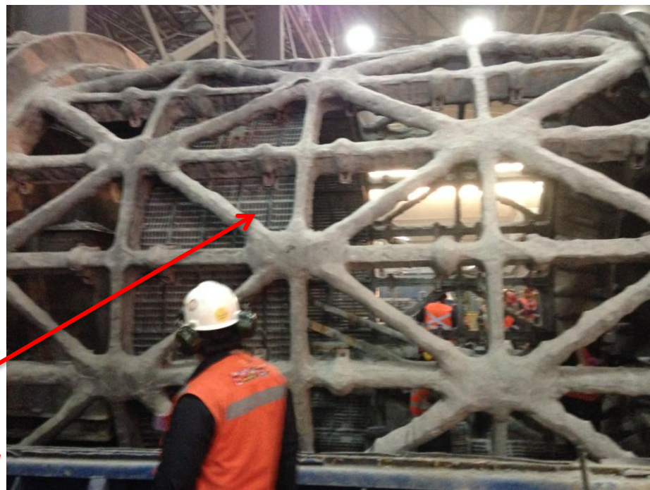
Состояние примерно через 3 месяца
